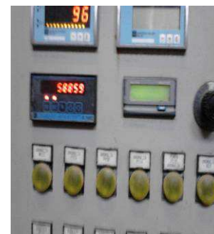
miglioramento 2015 aspirazione ITR- quadro dei nuovi ventilatori
